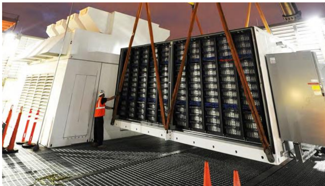
Figure 2 : le datacenter modulaire d'eBay utilise l'air extérieur pour son refroidissement
